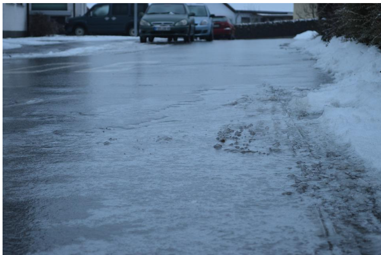
Рис. 1. Наледь на дороге
