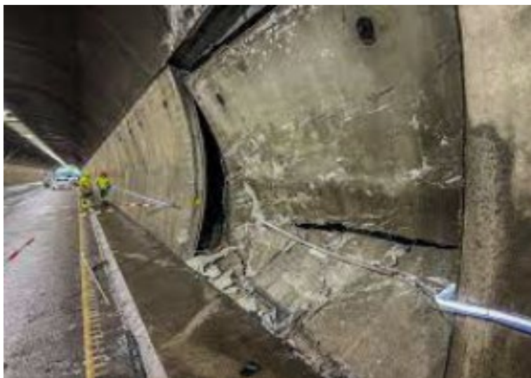
Рис. 6. Фрагмент обделки транспортного тоннеля с развившимися трещинами и локальным разрушением бетона после длительной эксплуатации [24]
